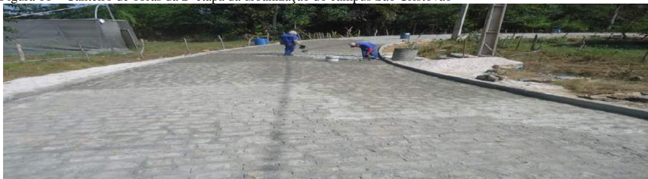
Figura 11 – Canteiro de obras da 2ª etapa da urbanização do campus São Cristóvão
