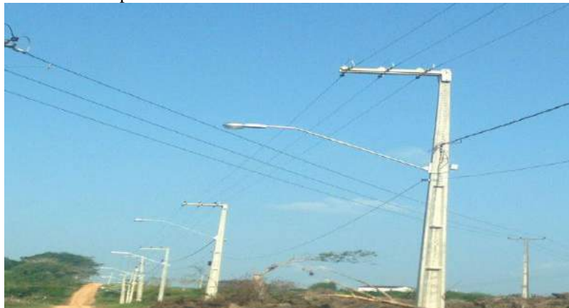
Figura 5 – Rede elétrica aérea no campus São Cristóvão
