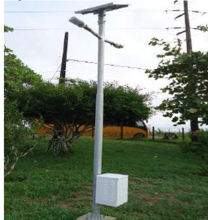
Figura 35 – Poste para aproveitamento de energia solar.
