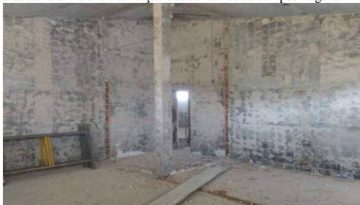
Figura 14 – Canteiro de obras da reforma e revitalização dos sanitários do campus Lagarto
