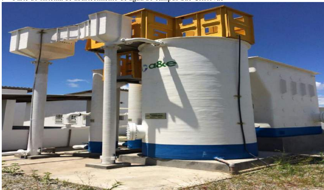
Figura 7 – Parte do sistema de abastecimento de água do campus São Cristóvão
