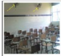
Figura 68- Ventiladores ligados. Fonte: Rosana R. Siqueira, 2012.
