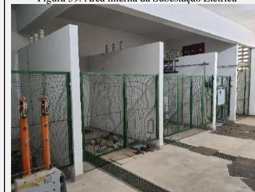
Figura 59. Área interna da Subestação Elétrica
